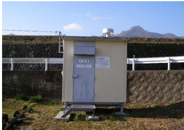
雨量観測所 (他ダム事例)
