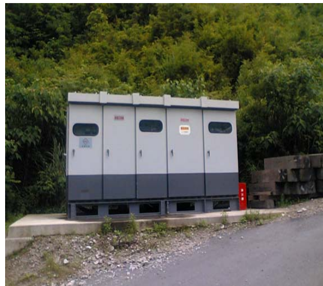
電力設備（他ダム事例）
