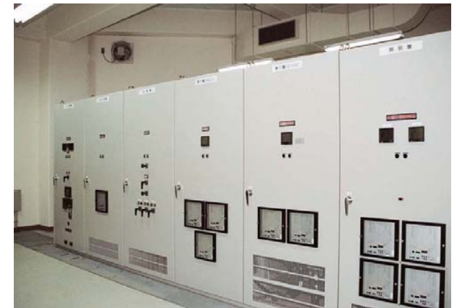
受変電設備 (他ダム事例)
