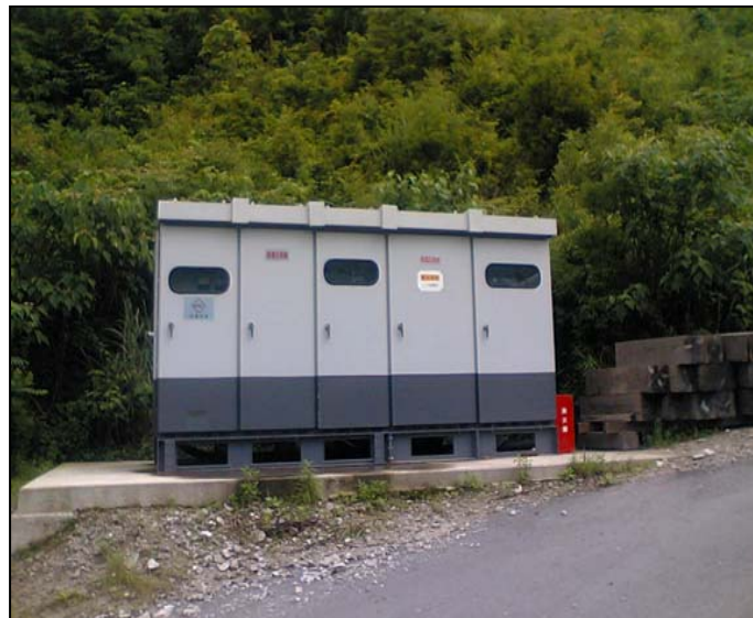
電力設備 (他ダム事例)
