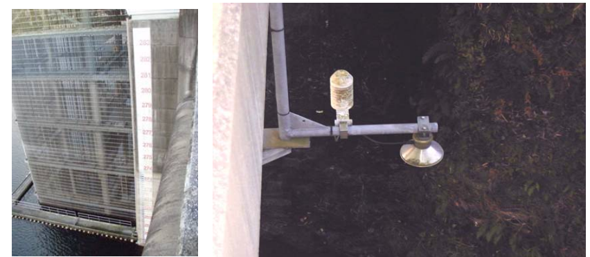
量水標と超音波水位計写真 (他ダム事例)
