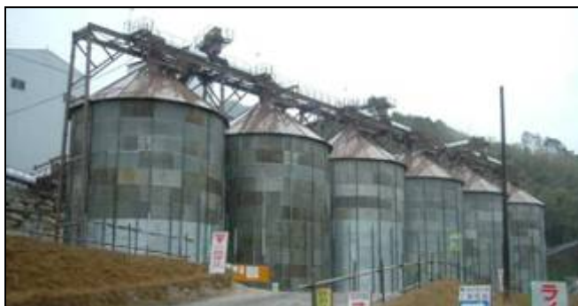
骨材設備写真(他ダム事例)
