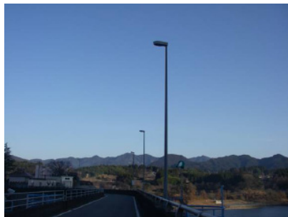
照明設備 (他ダム事例)
