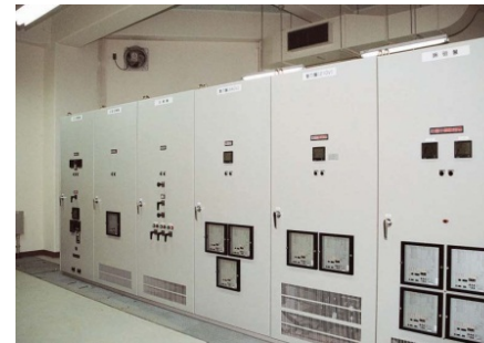
受変電設備 (他ダム事例)
