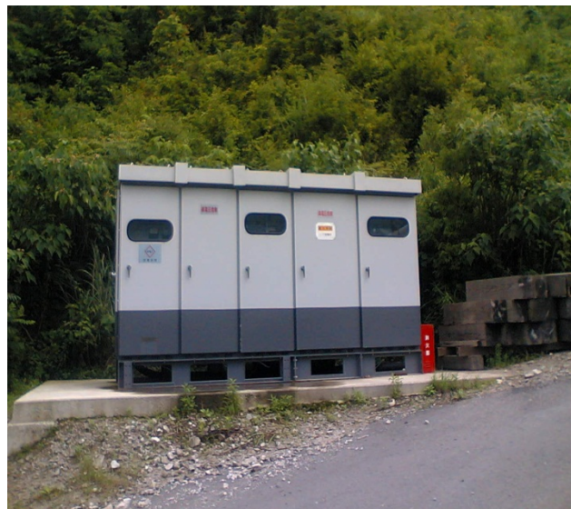
電力設備（他ダム事例）
