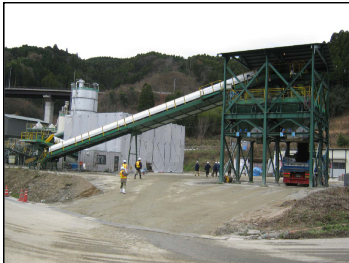
CSG材製造設備（他ダム事例）
