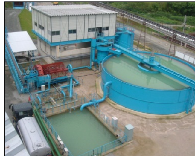
濁水処理施設（他ダム事例）
