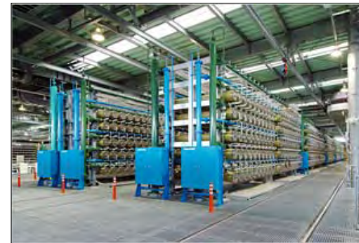
高圧RO膜設備
