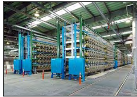
高圧RO膜設備
