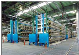
高圧RO膜設備
