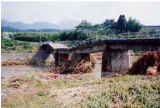
写真 2-2-1 平成5年9月洪水の被災状況 のつはる (七瀬川：大分市大字野津原 平野橋)
