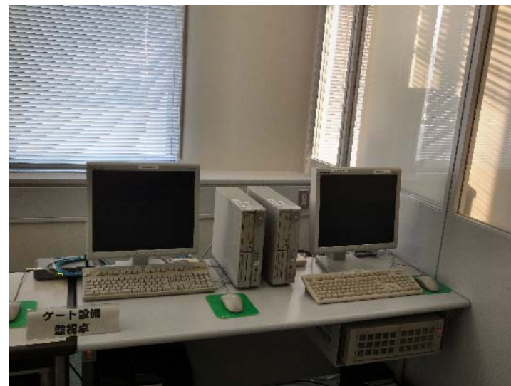
制御設備 (他事業事例)
