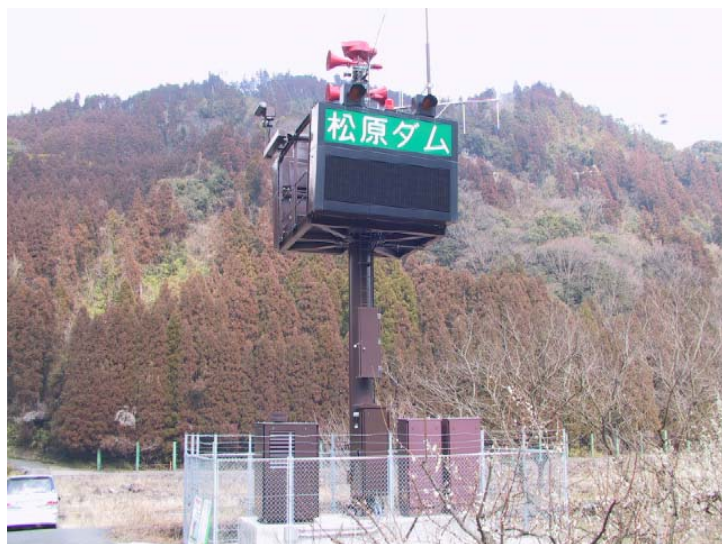
警報設備 (他事業事例)
