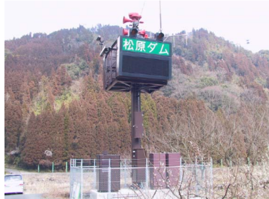
警報設備 (他事業事例)
