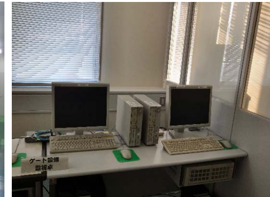
制御監視設備 (他事業事例)
