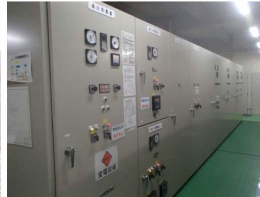
電気設備 (他事業事例)
