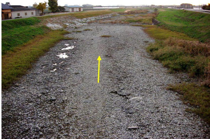
佐田川における瀬切れ (佐田川橋下流6/400km付近)
