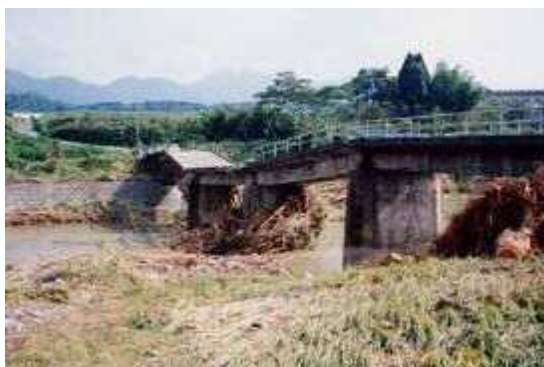
写真 2-2-1 平成 5 年 9 月洪水の被災状況 （七瀬川：大分市大字野津原 平野橋）
