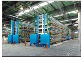
高圧RO膜設備
