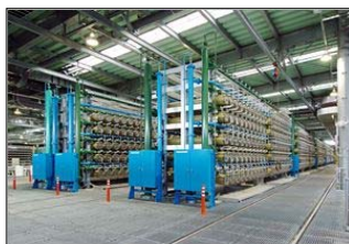
高圧RO膜設備
