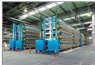
高圧RO膜設備
