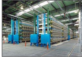
高圧RO膜設備
