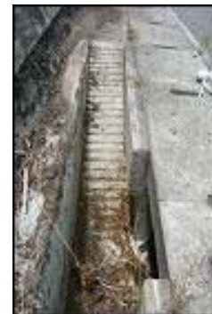
写真 3-2-2 小動物用脱出スロープ
