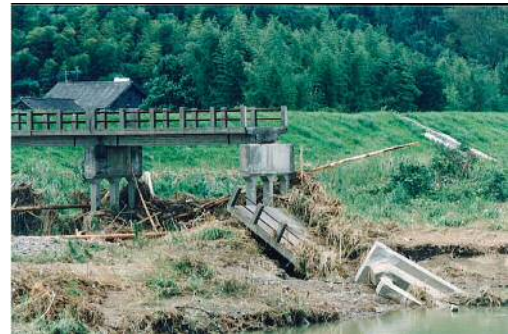
写真 2-2-6 平成 5 年 9 月洪水 流失した七瀬川の あらわす 露橋
