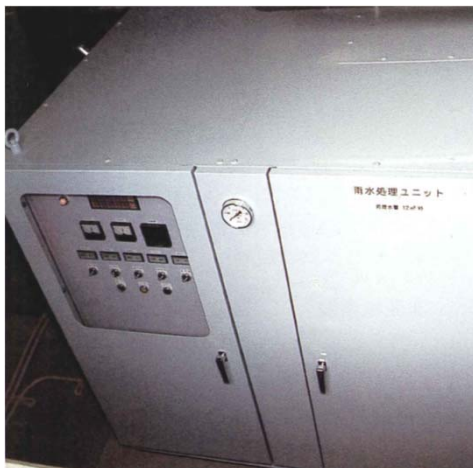
雨水処理ユニット(県立シーボルト大学)
