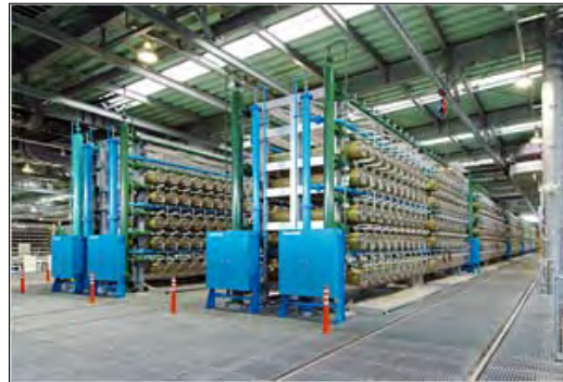
高圧RO膜設備
