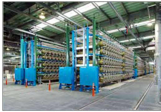
高圧RO膜設備
