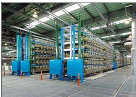
高圧RO膜設備
