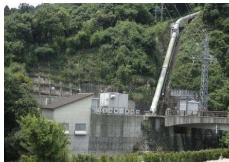
写真 2.2-42 広滝第二発電所
