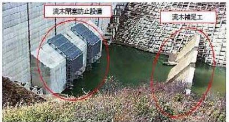
流木止め設備(流木閉塞防止設備+流木補足工)
