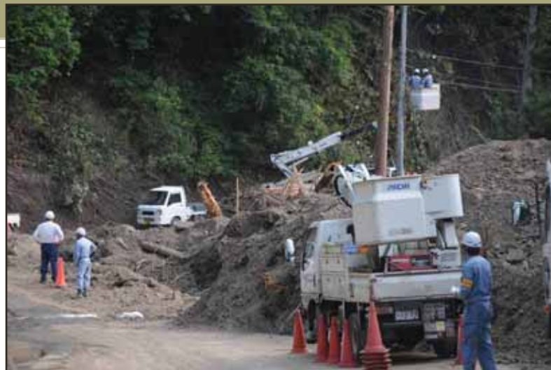
▲道路の崩壊で作業車両入れず、復旧に遅れ
