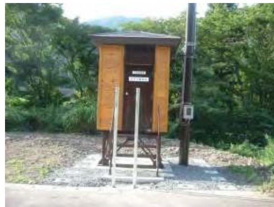
警報局舎写真（他ダム事例）
