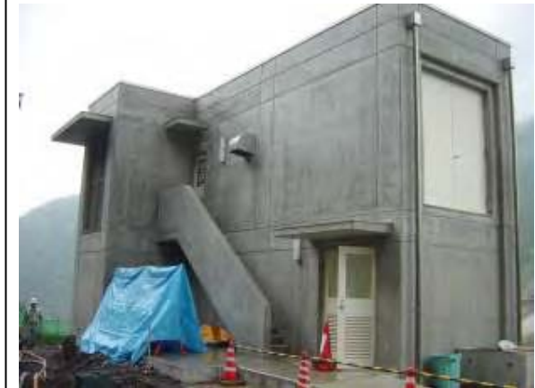
昇降設備写真（他ダム事例）
