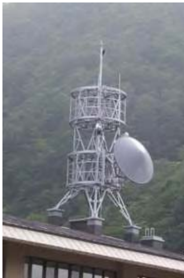
通信設備写真（他ダム事例）
