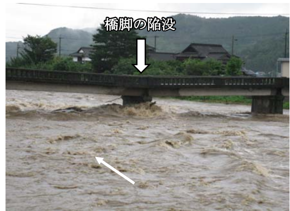
写真 2.3-2 洪水により被害を受けた橋梁
