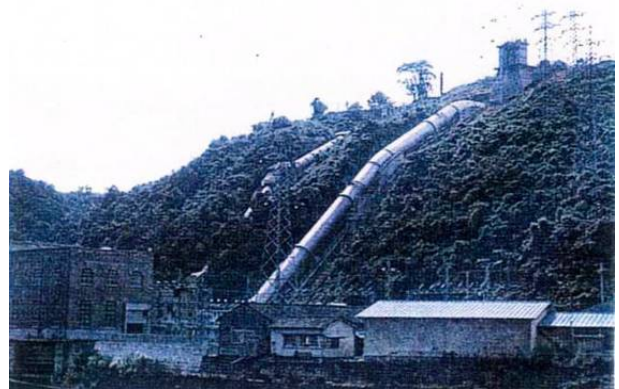
写真 2.2-5 女子畑発電所(日田市天瀬町)
