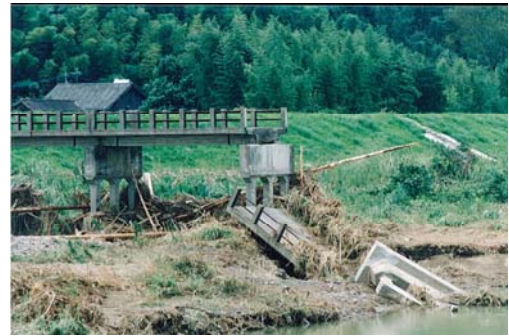
写真 2-2-6 平成 5 年 9 月洪水 流失した七瀬川の あrawasu 露橋
