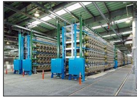
高圧RO膜設備
