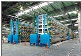
高圧RO膜設備
