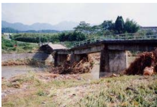
写真 2-2-1 平成5年9月洪水の被災状況 のつはる (七瀬川：大分市大字野津原 平野橋)
