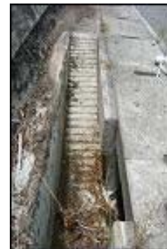
写真 3-2-2 小動物用脱出スロープ
