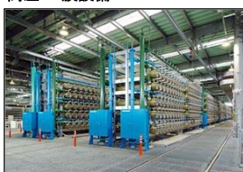
高圧RO膜設備
