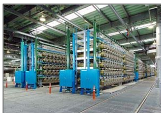
高圧RO膜設備
