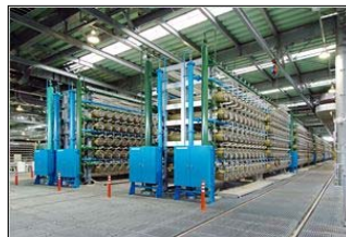
高圧RO膜設備
