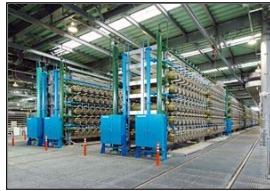
高圧RO膜設備
