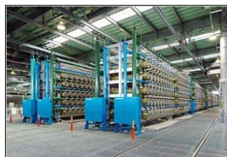
高圧RO膜設備
