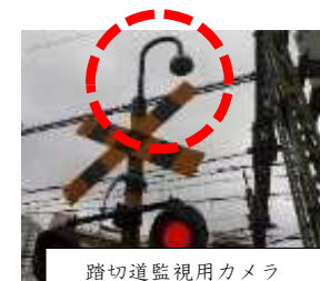
踏切道監視用カメラ
