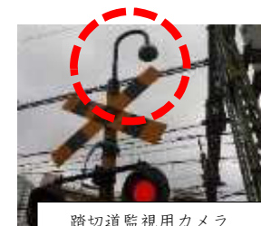
踏切道監視用カメラ
