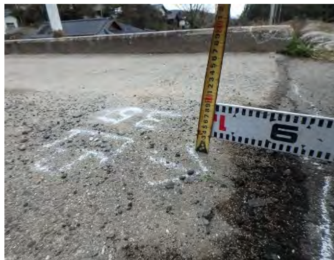
写真1.21-2 舗装の異常の計測事例
