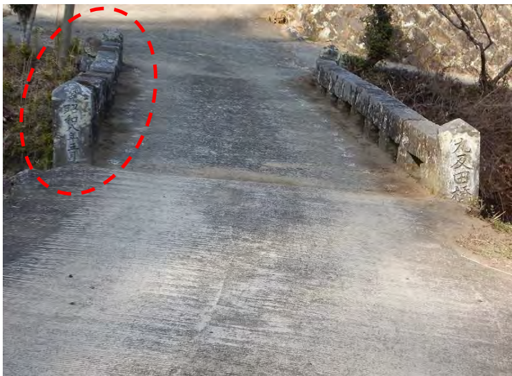
写真1.24-1 防護柵の通りの異常の事例
