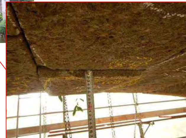
写真1.14-1 輪石のずれ(抜け出し)の事例
