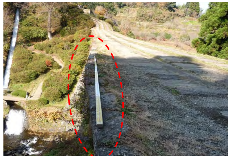
写真1.24-2 防護柵の通りの異常の事例
