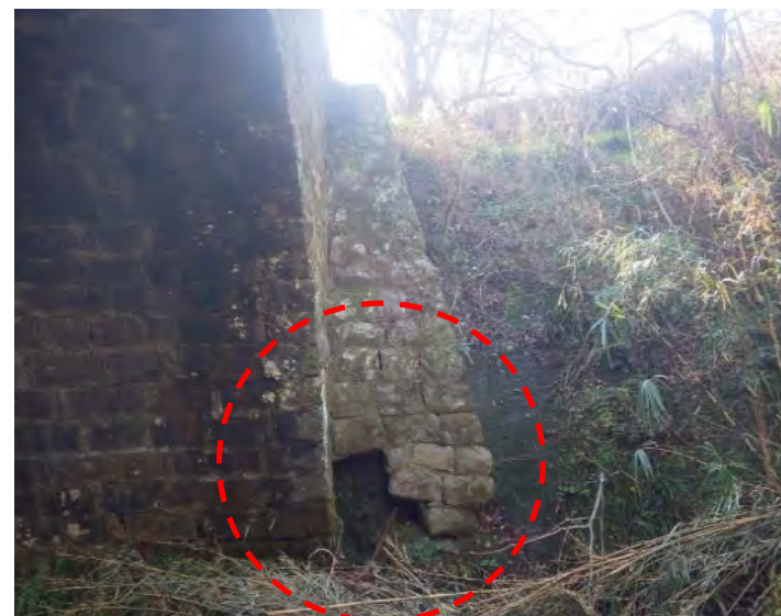
写真1.24-4 護岸の変状の事例
