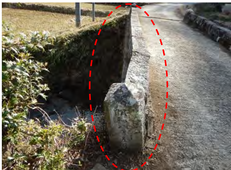
写真1.24-3 防護柵の通りの異常の事例
