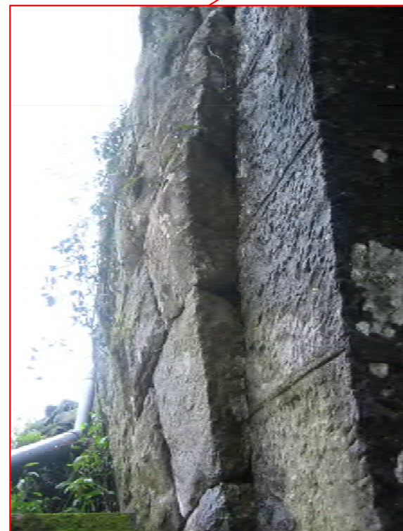
写真1.17-1 壁石のはらみ出しの事例
