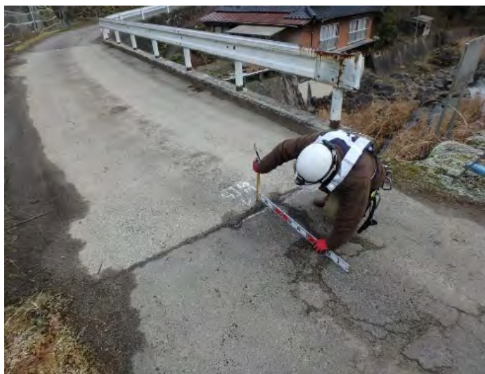
写真1.21-1 舗装の異常の事例
