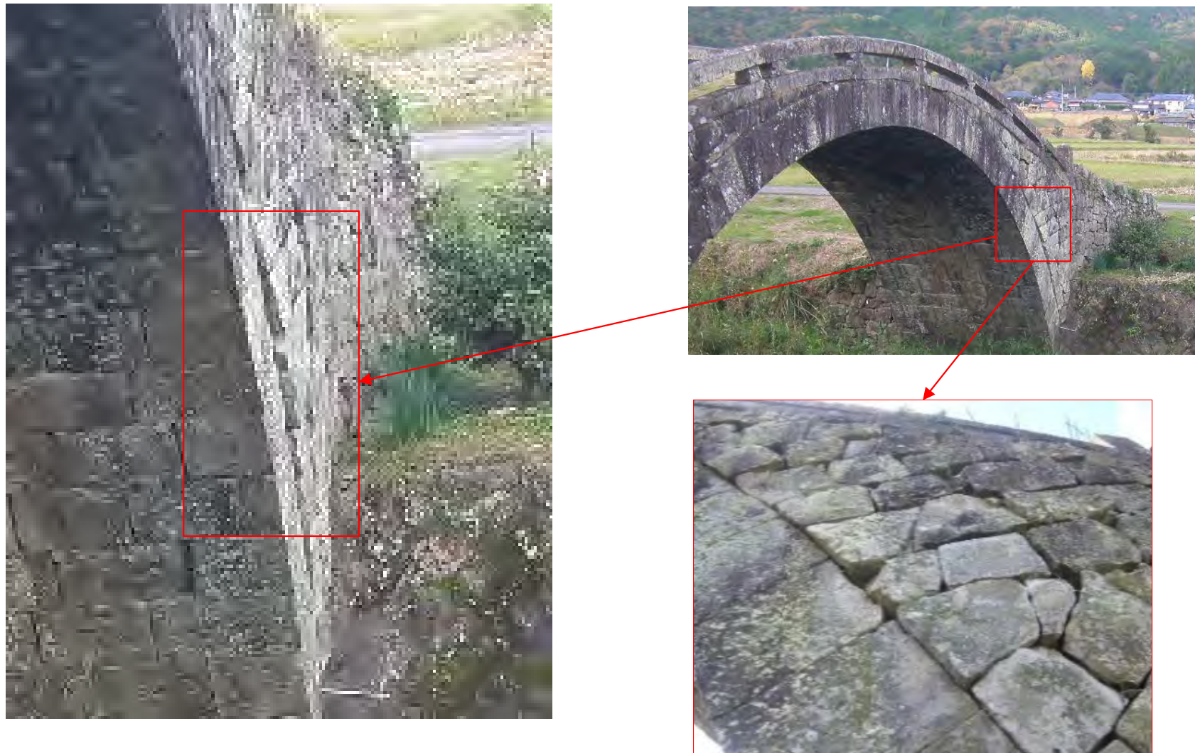
写真1.12-1 壁石の通り・はらみ出しの事例
