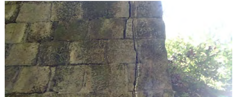
写真1.15-1 輪石の破断(亀裂)の事例
