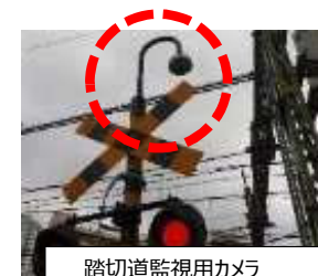
踏切道監視用カメラ
