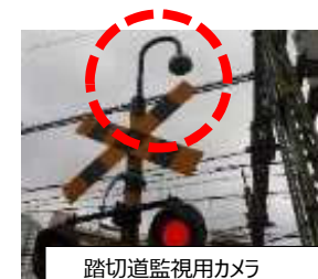
踏切道監視用カメラ
