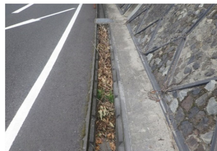
【側溝の土砂堆積】
