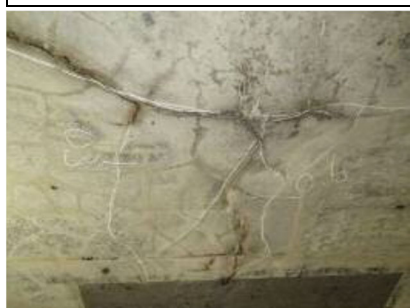
【壁面のひび割れ】
