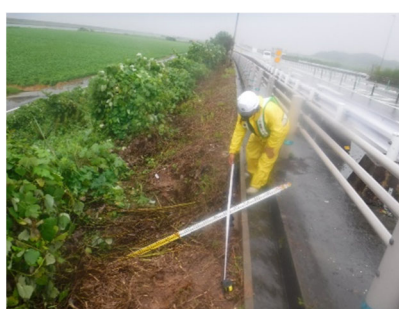
【法面の異状発見】
