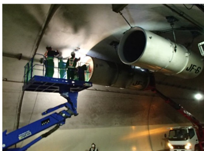
【トンネル換気設備の点検】
