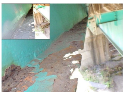
【橋梁損傷（主桁の腐食）】
