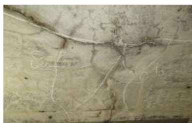
【壁面のひび割れ】
