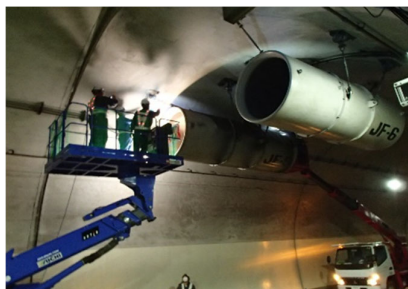
【トンネル換気設備の点検】
