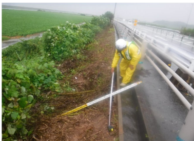
【法面の異状発見】
