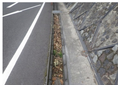
【側溝の土砂堆積】
