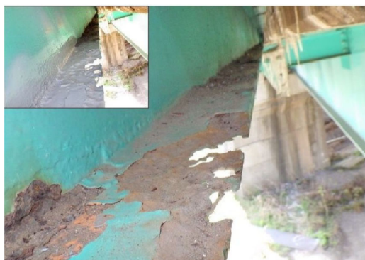
【橋梁損傷（主桁の腐食）】
