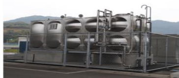
受水槽（貯水タンク）
