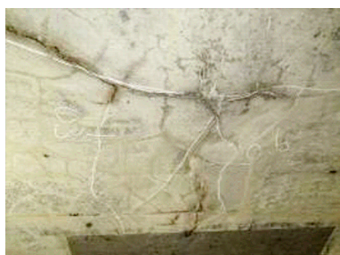
【壁面のひび割れ】
