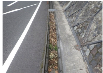
【側溝の土砂堆積】
