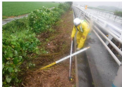
【法面の異状発見】
