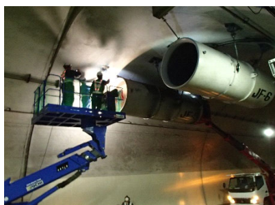
【トンネル換気設備の点検】
