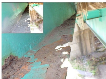
【橋梁損傷（主桁の腐食）】
