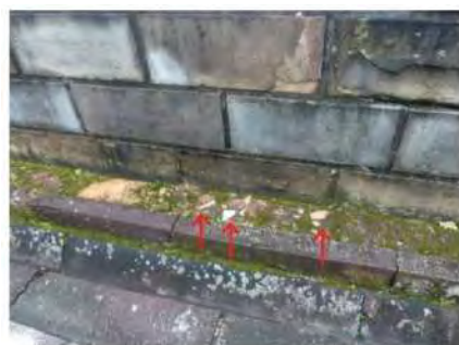
写真-1.1 崩落片の発生事例 10)
