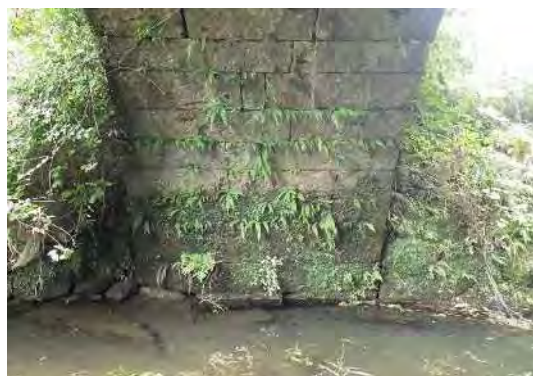
写真-2.5 目地（無処理）
