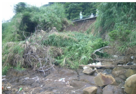
被災の状況&lt;のり面崩落&gt;
