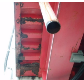
◆ 損傷状況 (デッキプレート腐食)
