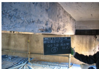
点検結果&lt;主桁鉄筋の露出&gt;
