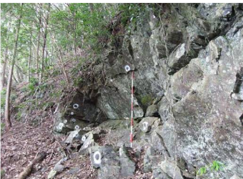
【落石・崩壊判定の例 R10延岡市】
