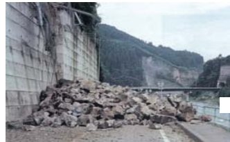
図2 災害発生状況 山ノ釣地区 (55. 8. 23)
