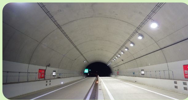
道路照明のLED化 (トンネル)
