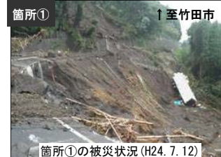
箇所①の被災状況(H24.7.12)
