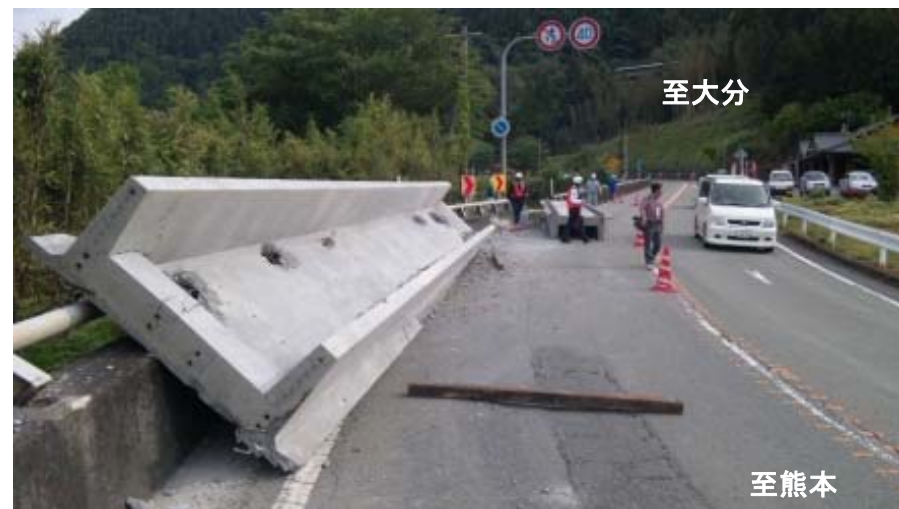
【写真1】滝室坂でのコンクリート柵落下 (平24年5月23日 約5時間通行規制)
