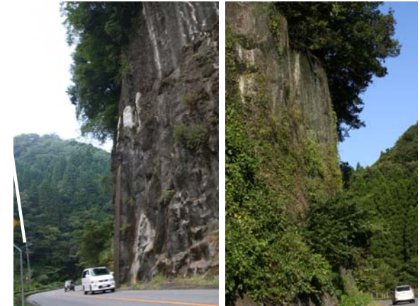
▼現地状況(防災点検要対策箇所)
