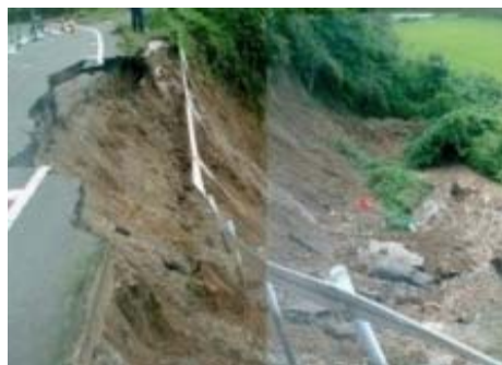
▲旧蘇陽町大野(現山都町) 法面崩壊(H17.9)
