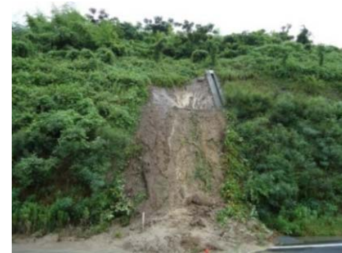
写真①：並行する国道3号 【法面崩壊状況】
