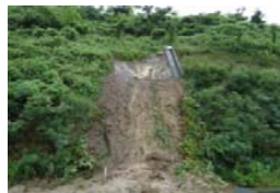
写真1 国道3号の法面崩壊状況
