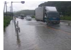
写真3 国道3号の路面冠水状況
