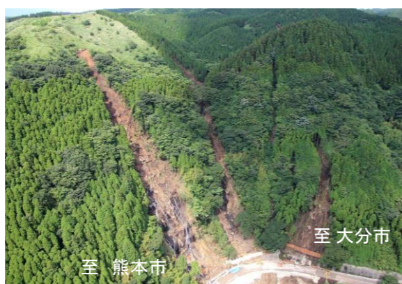
写真2 H24.7九州北部豪雨の通行止め(滝室坂)
