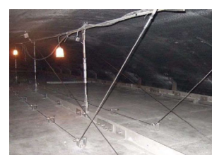
フェールセーフ設置状況
