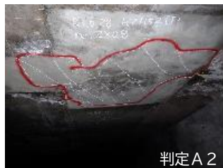
S 6 区間 床版下面のはく離（浮き）
