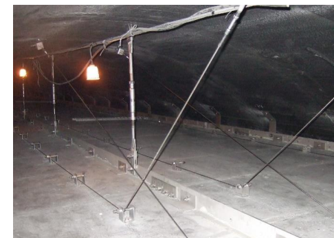
フェールセーフ設置状況
