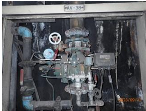
【非常用設備更新】
