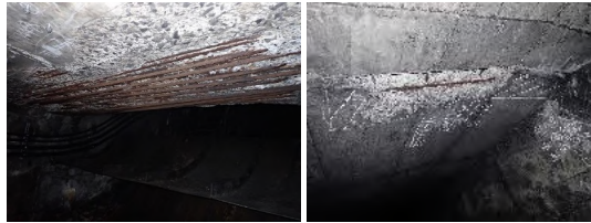
床版下面の鉄筋露出
