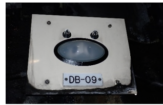
火災検知器 (設置から11年経過)
