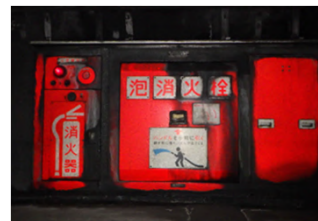
消火栓 (設置から26年経過)
