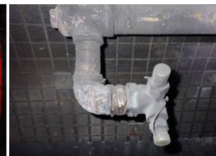
水噴霧設備 (設置から25年経過)
