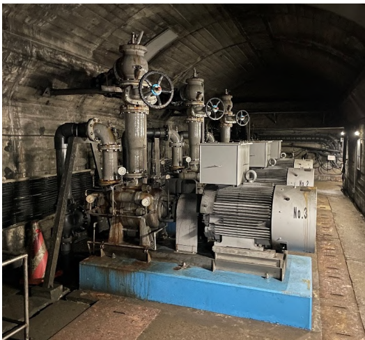
排水ポンプ (設置から14～30年経過)
