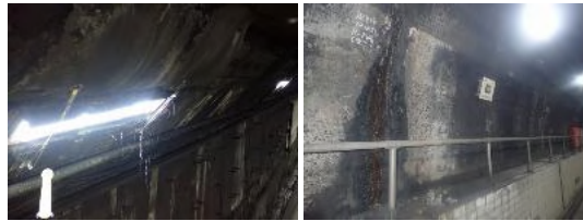
覆工からの漏水
