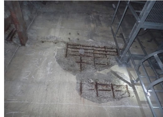
鉄筋露出状況
