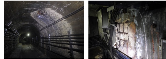
覆工に豆板の変状
