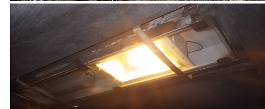
照明設備 (設置から22年経過)
