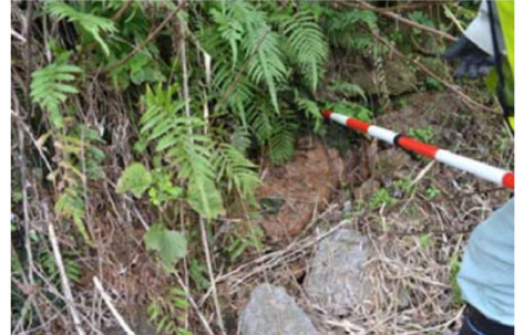
現地点検状況(崩落岩塊を確認)
