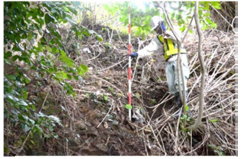
現地点検状況(不安定斜面を確認)
