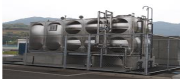
受水槽（貯水タンク）
