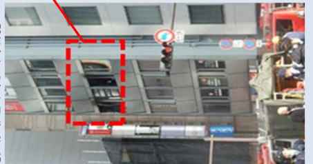
【火災建築物 外観】
